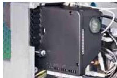
Automatika se zapalovacím transformátorem
