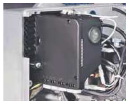
Automatika se zapalovacím transformátorem
